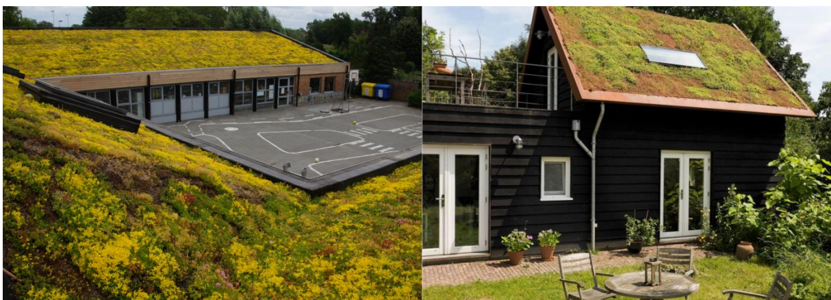
Figuur 43. Voorbeelden van een groendak. Links wordt een groendak toegepast op een groot, weinig hellend dak van de basisschool in Meerdonk Sint-Gillis-Waas. Rechts is het toegepast op het dak van een privé woning. Bron: Blauwgroen Vlaanderen.
